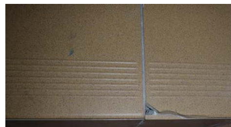
Rękojmia jest podstawową zasadą odpowiedzialności za wadliwość usług, w tym przypadku niewłaściwie wykonany montaż płytek ceramicznych spowodował ubytki w okładzinie. Fot. archiwum kwartalnika „Wokół Płytek Ceramicznych”
